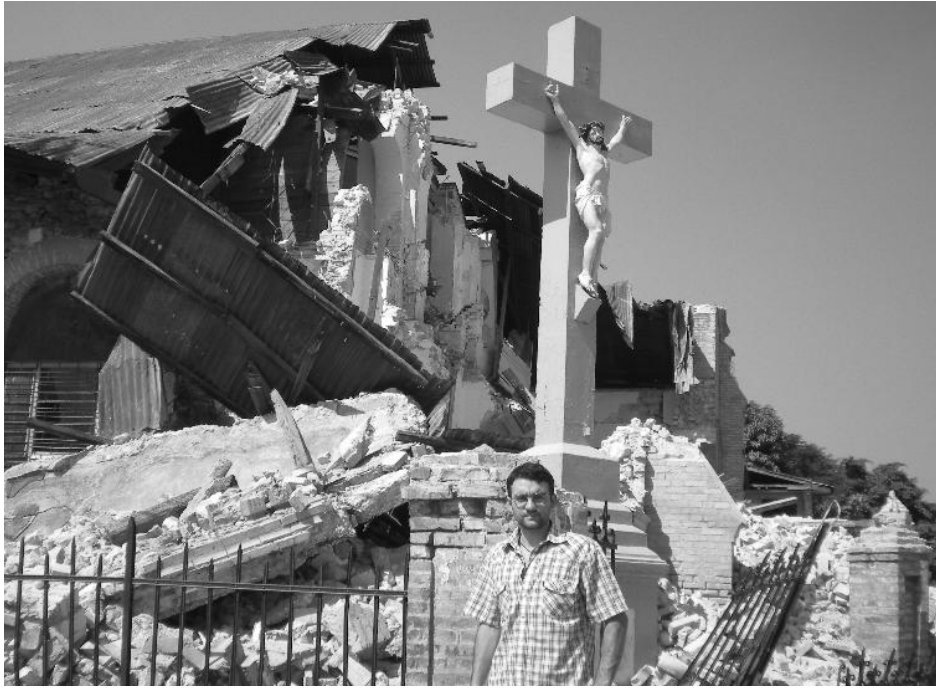
Zniszczeniu uległa większość historycznych budynków w Port-au-Prince – stolicy Haiti.
